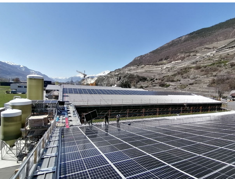
Park Mangold: 11'000 m 2 Photovoltaikanlagen - Jahresproduktion: 2'400 MWh/Jahr, damit können 540 Haushalte versorgt werden)
