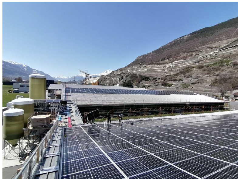
Parc Manguold : 11'000m 2 de système photovoltaïques - Production annuelle : 2'400 MWh/an, équivalent à 540 ménages)
